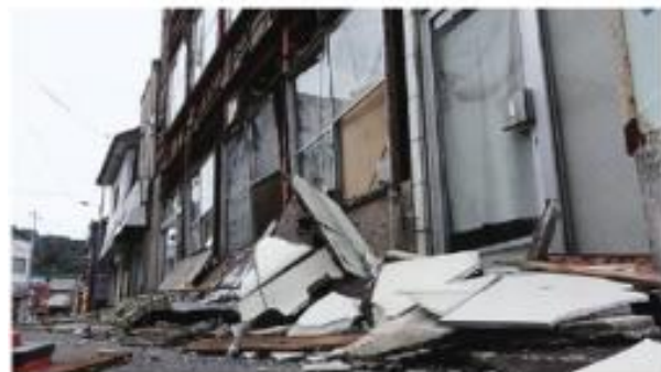
鳥取県中部地震での被害（倉吉市内）
