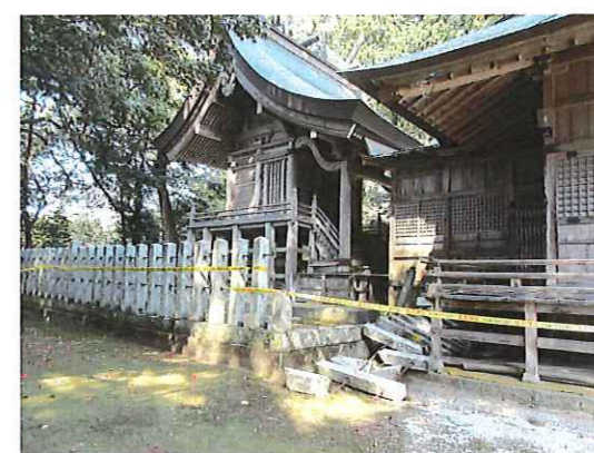
雪ずりの重みで倒れた垣。
