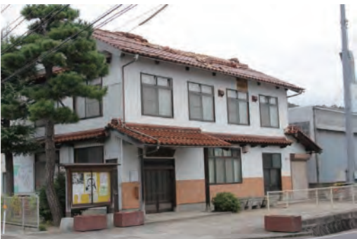
瓦屋根の棟が崩れた和田公民館
