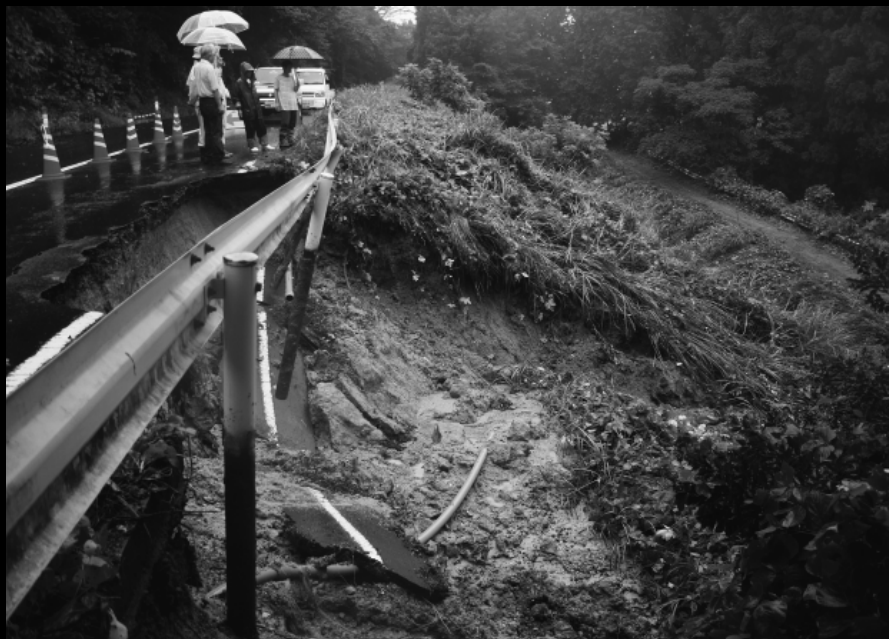
▲道路が崩落し、水道管が損壊(関金町堀)(9月3日(土)午後4時撮影)
