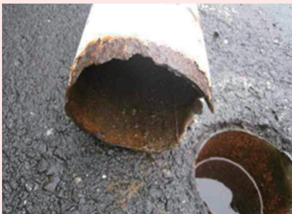
ポールの根腐れによる倒壊
