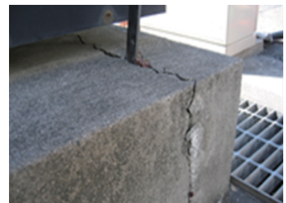
看板基礎のひび割れ
