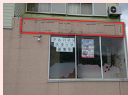
落下した後の壁面
