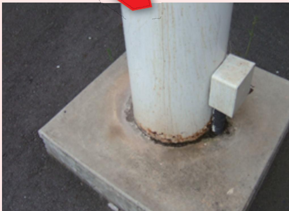
ポールの根元にサビが発生
