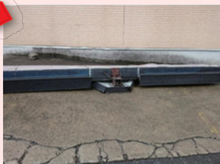
落下した欄間看板
