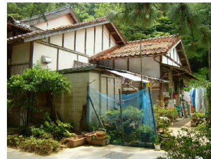
管理人室が設置されたこともあり、歴史的建物の外観を阻害している部分がある。歴史ある打吹公園の景観に配慮した補修が必要である。
