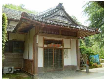
床は地面から2尺5寸上がりである。スロープなどの身障者に配慮した施設の充実が必要である。
