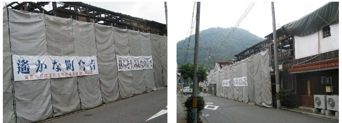
火災直後の状況
