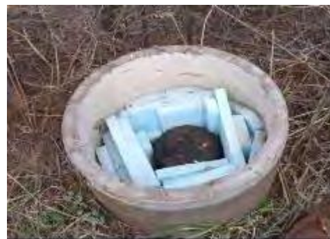
給水栓ボックス内の保温状況
