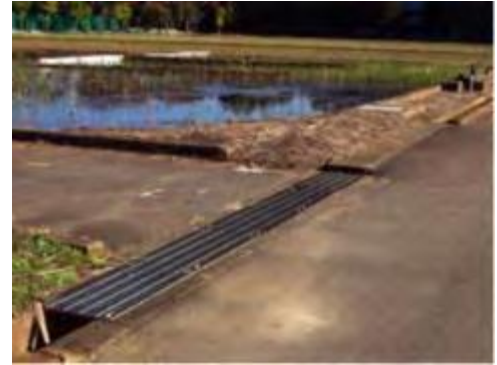
コンクリート蓋とグレーチング
