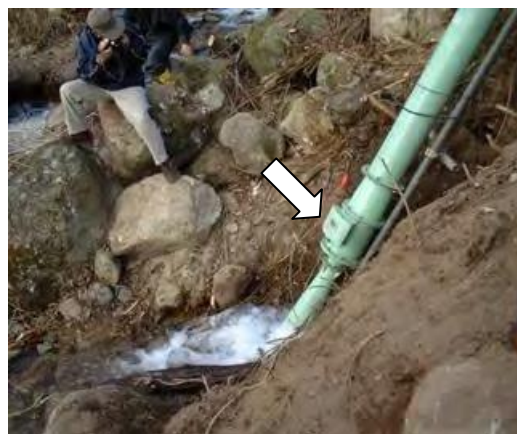
簡易な発電機 (図の矢印)
