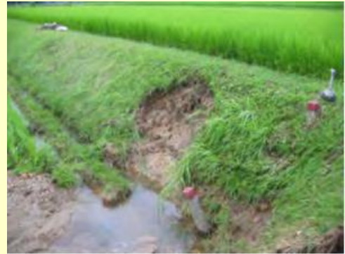
農用地法面が崩れた状況
