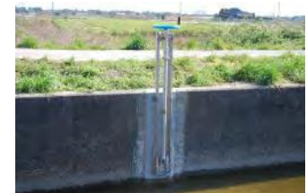
巻き上げ式ゲート（分水用ゲート）
