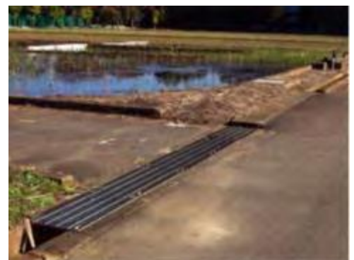
コンクリート蓋とグレーチング
