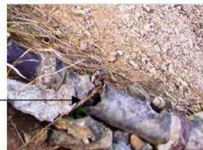
古い樋管（陶製）の破損
