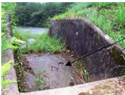
洪水吐底板（コンクリート）の欠損
