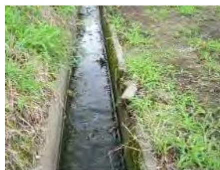
破損したU字溝
