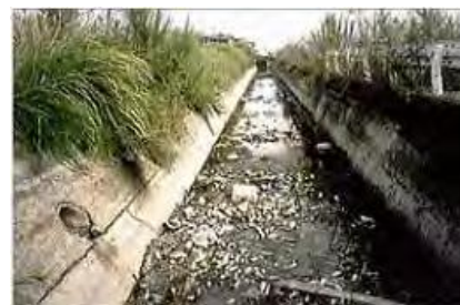
水量が減少した水路
