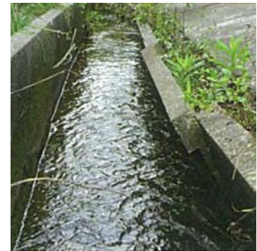
側壁の倒壊（側溝）
