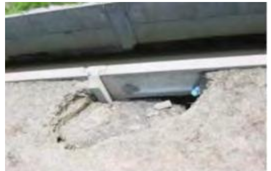
水路側壁の空洞状況
