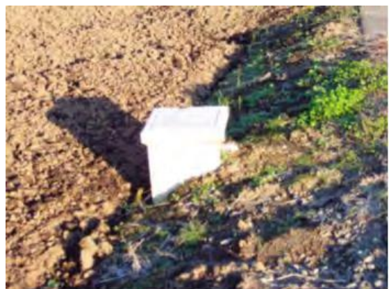
傾いた給水栓ボックス
