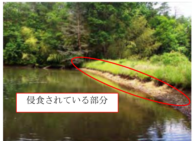
侵食が生じているため池堤体
