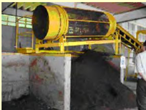
堆肥プラント
