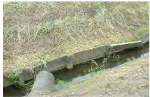
水路側壁のはらみの状況
