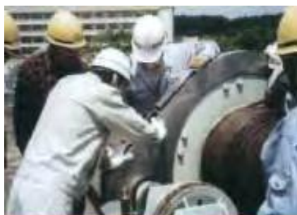
ポンプ点検状況
