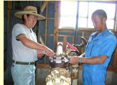
ポンプの点検状況
